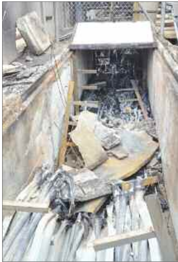
Le feu a endommagé plusieurs câbles de la centrale de Bel-Air
